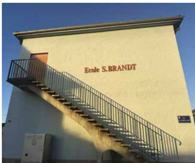
La construction d'un nouvel escalier de secours est programmée à l'école Brant. Les travaux devraient débuter cet été.
